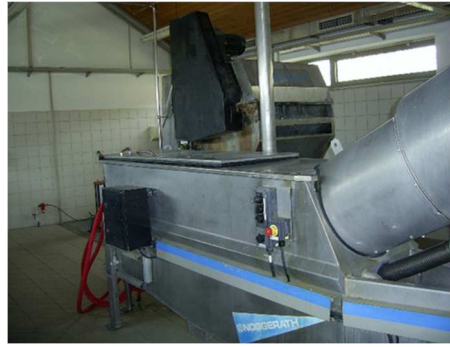
Paternostersiebrechen mit Rechengutwäsche
