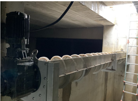
Noggerath® Überlaufsieb OVF an der Mischwasserentlastung
