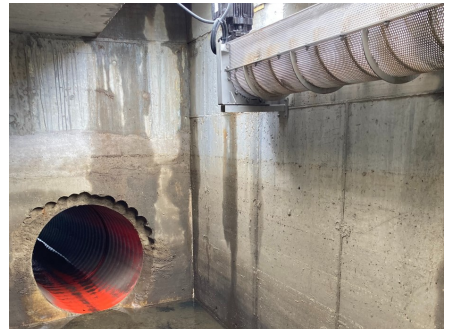
Ablauf-Rohrleitung zur Flussmündung
